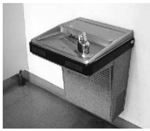
市内中学校に設置された冷水機
