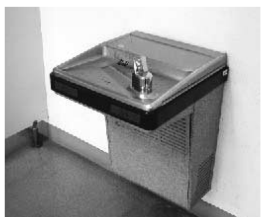
市内中学校に設置された冷水機
