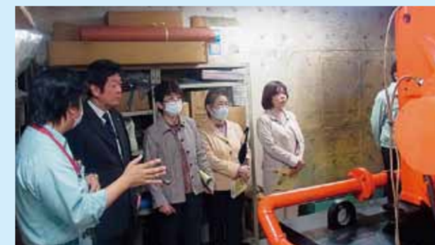
常時60%を自家発電している非常電源設備
