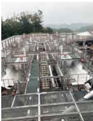
メタンガス発酵槽
